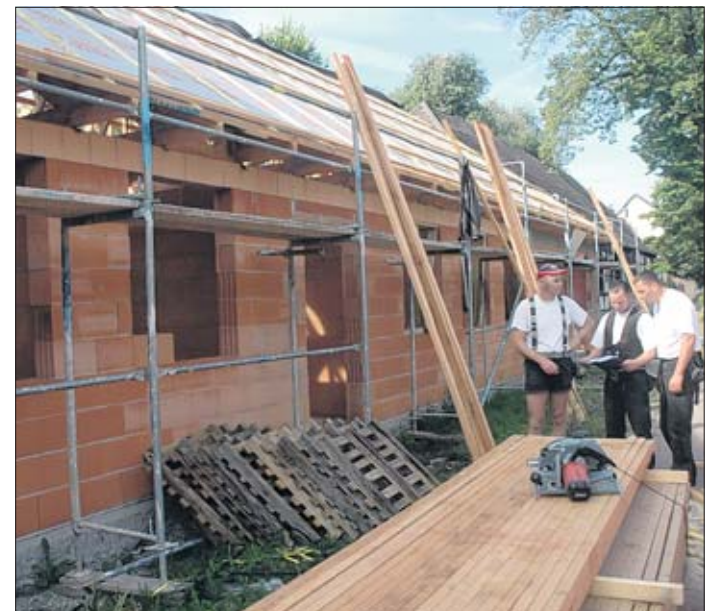
Bauarbeiten gehen zügig voran. Domenik Hild, Sören Krause und Dirk Heinrichsdorf (v. l.) wollen das Dach eindecken. Foto: R. Malsch
